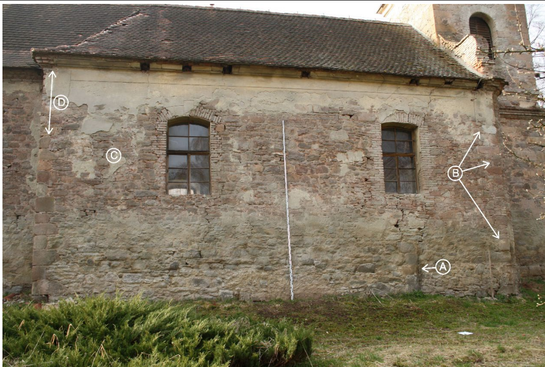
Čelní pohled na severní průčelí lodi. A – vertikální spára určující původní délku středověké lodi s dochovanými kvádry spodní partie nárožního armování. B – středověké kvádry druhotně použité při prodloužení lodi v roce 1788. C – zazděný okenní otvor pocházející z blíže neurčitelné doby před rozšířením lodi roku 1788. D – přezděné nároží související patrně s rozšířením lodi roku 1788. Foto: Jaroslav Skopec 2014.
